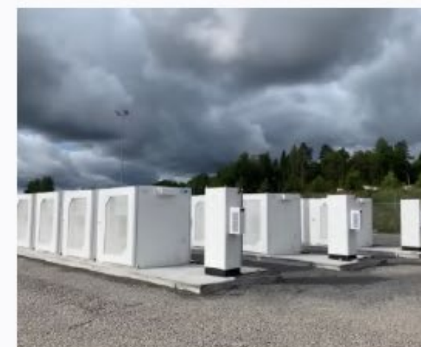
MWS INTERNATIONAL 20 MWH ; FINNLAND ; GEBAUT 2021-2022 GRÖSSTES BESS FINNLANDS
