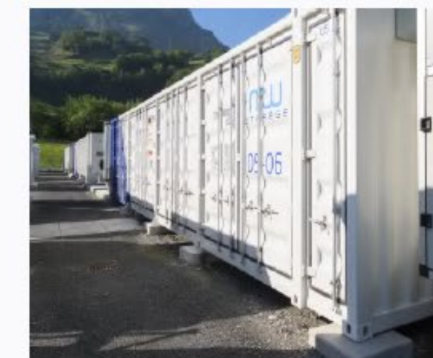
MWS INGENBOHL 2 8 MWH ; SCHWEIZ ; GEBAUT 2023-2024 AUSBAU DES BESTEHENDEN BESS
