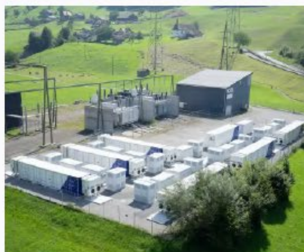
MWS INGENBOHL 20 MWH ; SCHWEIZ ; GEBAUT 2019-2020 GRÖSSTES BESS DER SCHWEIZ
